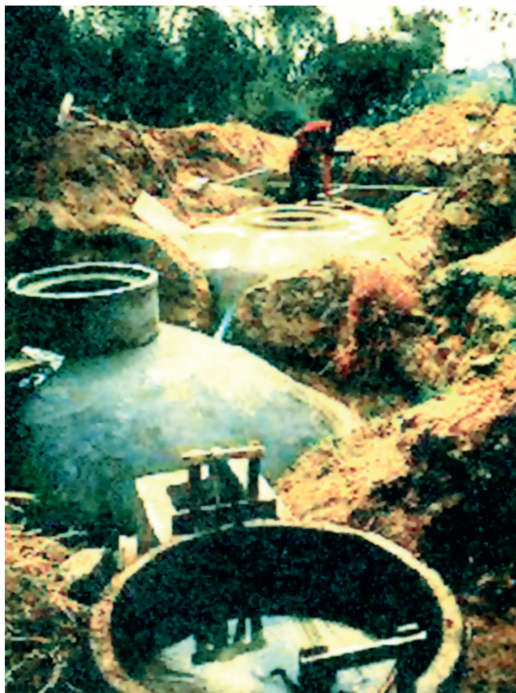
Εικόνα 9-7. Μονάδα παραγωγής βιοαερίου στην Ταϋλάνδη.
